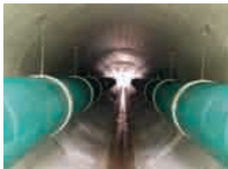
Stauraumkanal mit Grobstofffiltern
